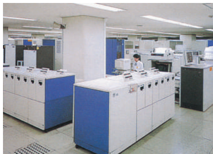
埼玉銀行 コンピュータールーム
