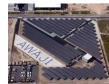
太陽光パネル/あわじメガソーラー
